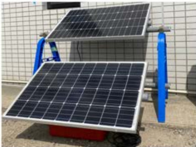
単管バリケードに設置した事例
